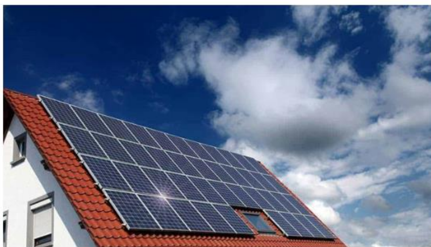
Một số hộ gia đình đã lắp đặt hệ thống điện mặt trời mái nhà.
